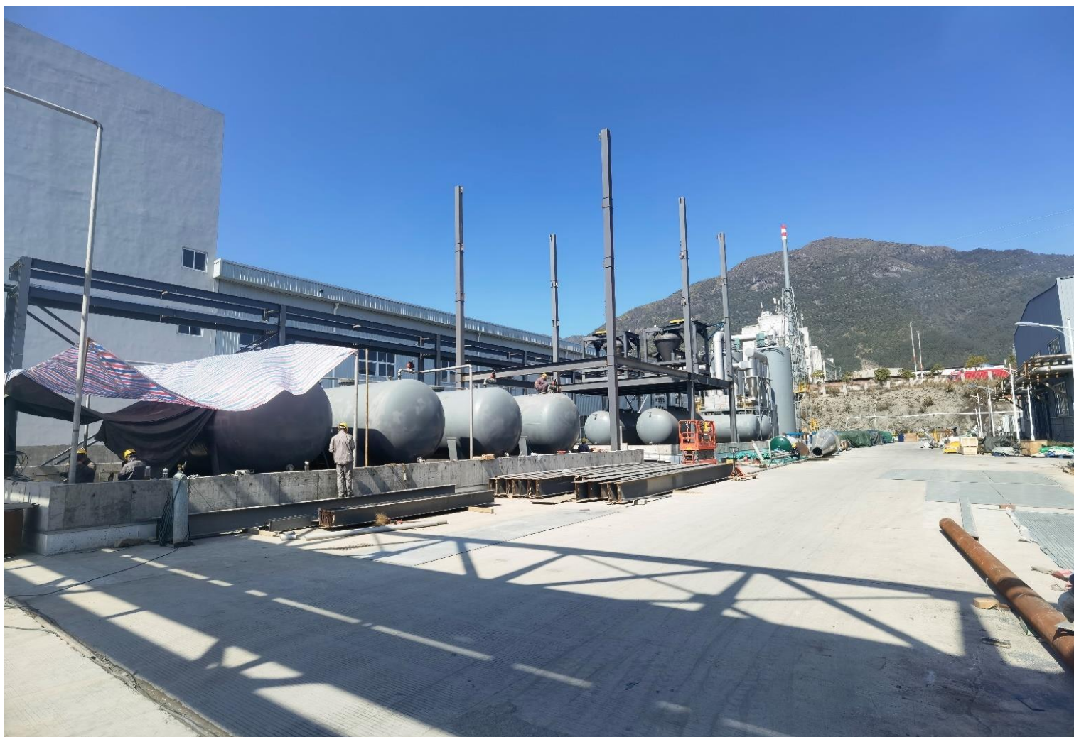
图 5.2-3 废气处理设施建设情况（分项+整体）
